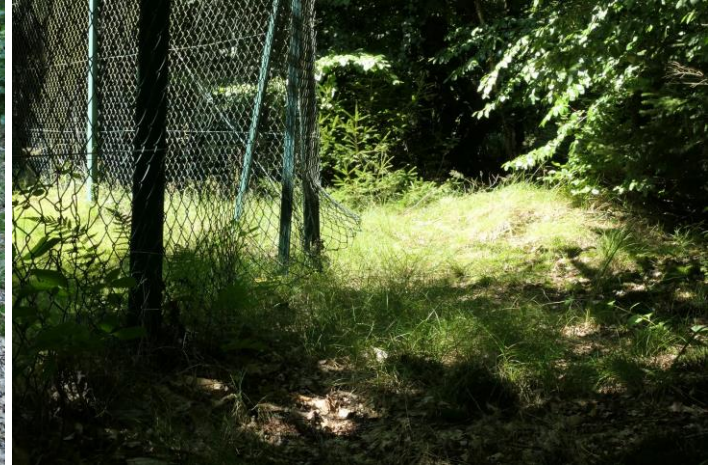
Abb. 13 Landessammelstelle, Loch im Maschendrahtzaun, Nordecke 10.08.2024 #1506
